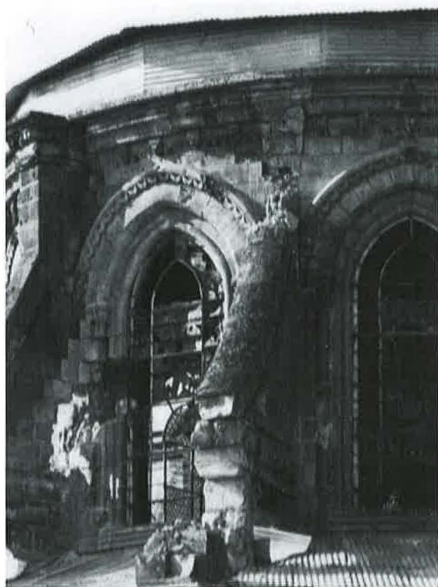
Fig. 8. Noyon, cathédrale. Vue extérieure d'une cavité du chevet avant restauration. Cl. MH 26098.
